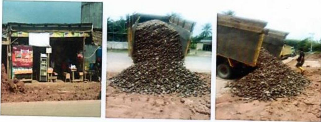
Proses penghamparan batu kerikil pada bahu jalan yang terdapat sisa tumpukan tanah sehingga tidak licin dan tidak membahayakan pengguna jalan
