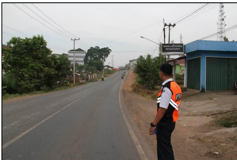
Gambar 38. Kondisi marka tengah dan tepi ruas Jalan Sei Lilin – Betung KM 73 Kecamatan Betung, Kabupaten Banyuasin, Provinsi Sumatera Selatan yang terlihat kotor dan buram.
