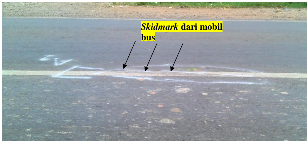
Gambar 15. Kondisi permukaan jalan pada posisi 12 meter sebelum titik tabrakan.
