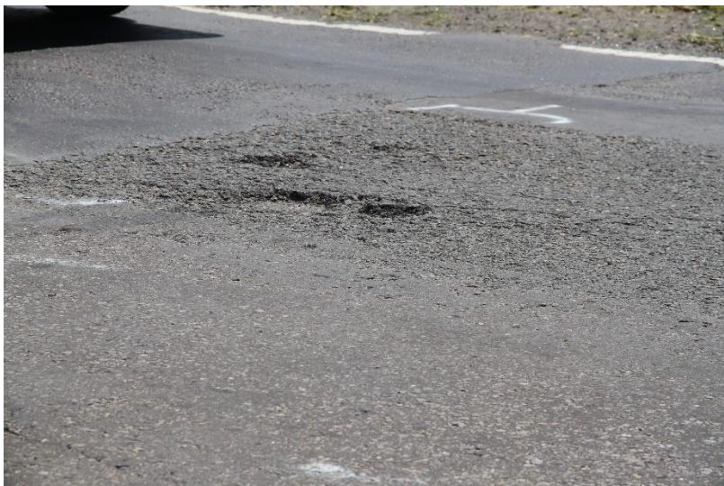
Gambar 4. Kondisi jalan berlubang
