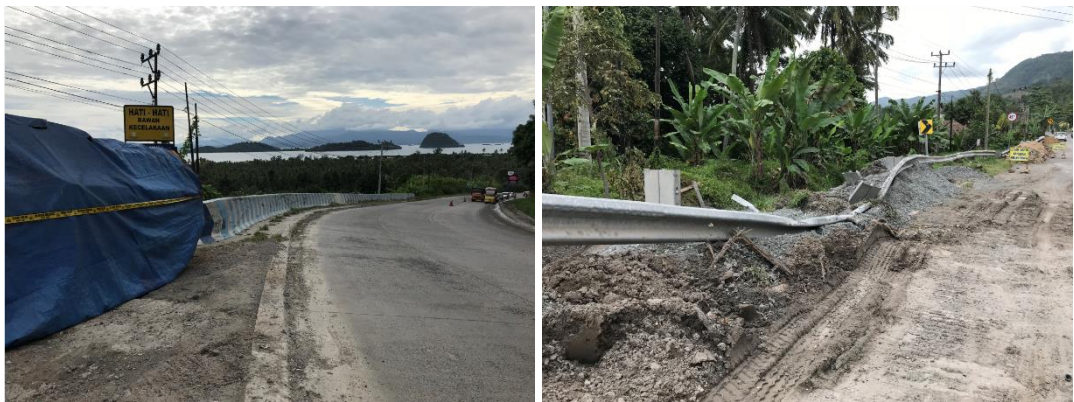
Gambar 18. Kondisi Pagar Pengaman ( Guardrail )
