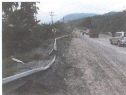
Guard rail yang rusak (foto atas diambil dari arah Bandar Lampung, foto bawah diambil dari arah Bandar Lampung)
