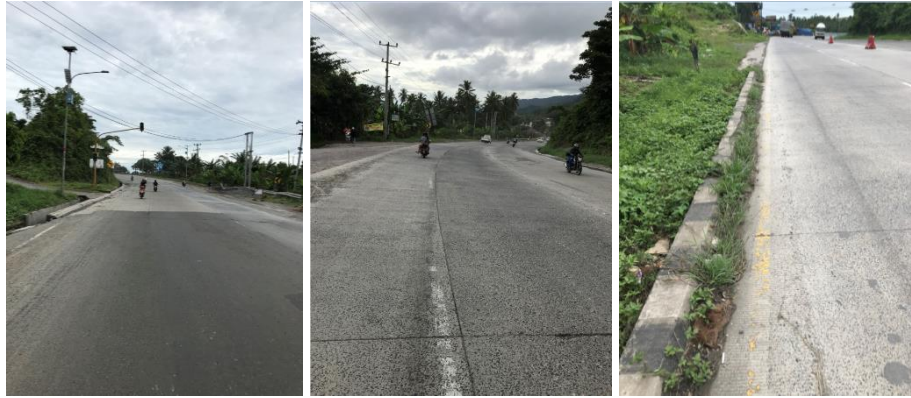
Gambar 15. Marka Jalan yang Sudah Pudar
