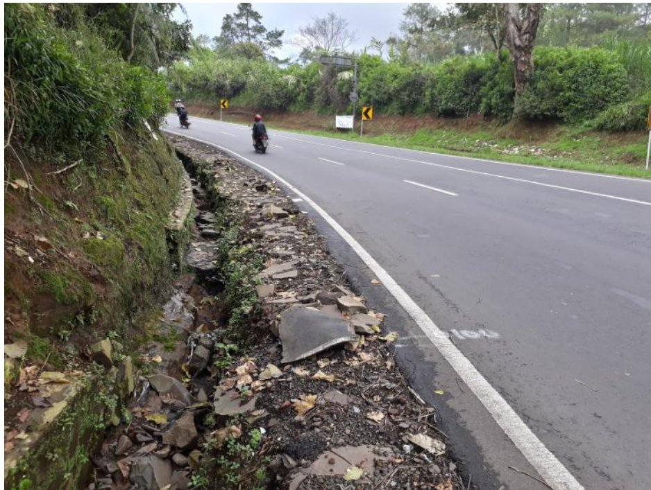
Gambar 22. Kondisi Drainase Jalan Turunan Emen
