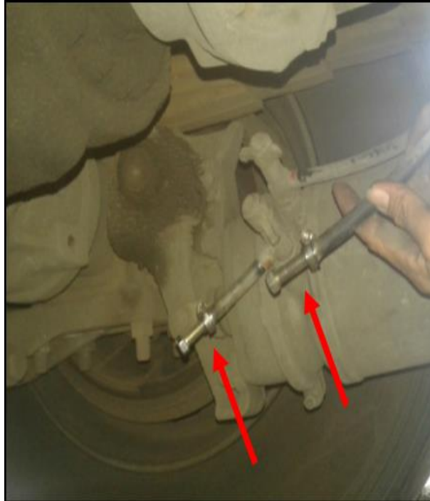
Gambar 8. Kondisi Thermoplastic Hose yang Terpotong
