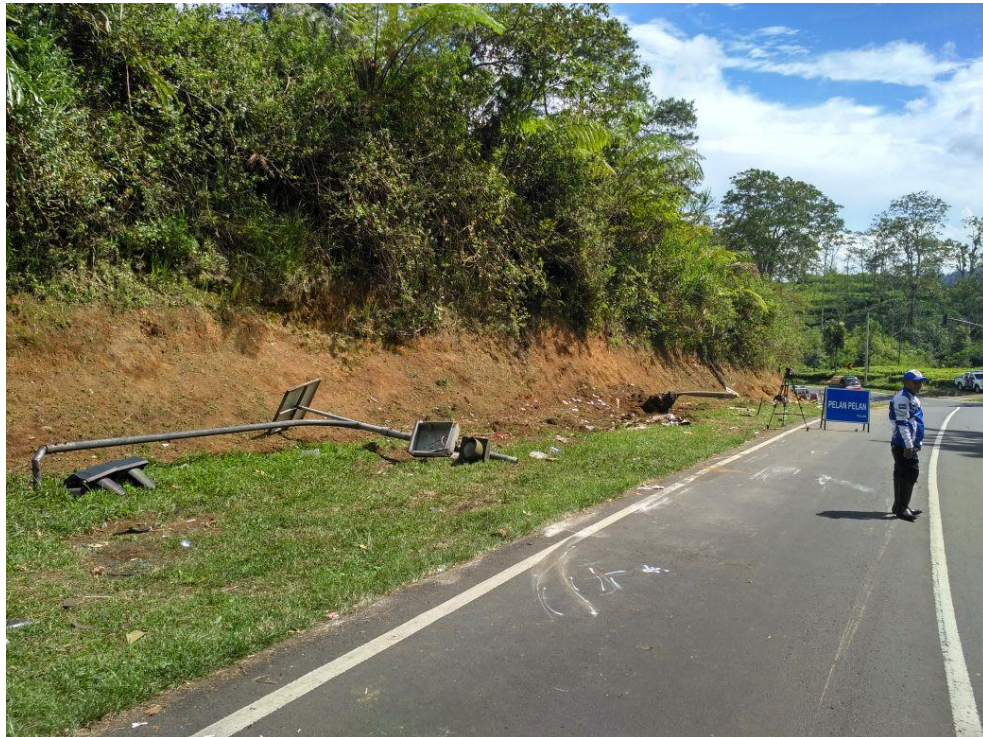
Gambar 5. Kerusakan Tiang Warning Light
