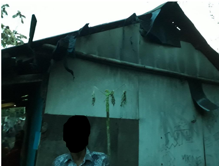
Gambar 17. Rumah penduduk yang ikut terbakar.
