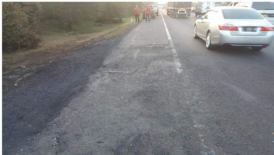
Gambar 15. Kondisi ruas jalan tol di lokasi terjadinya kecelakaan.
