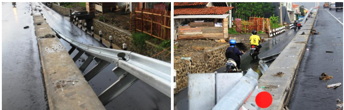
Gambar 4. Kerusakan Pagar Pengaman
