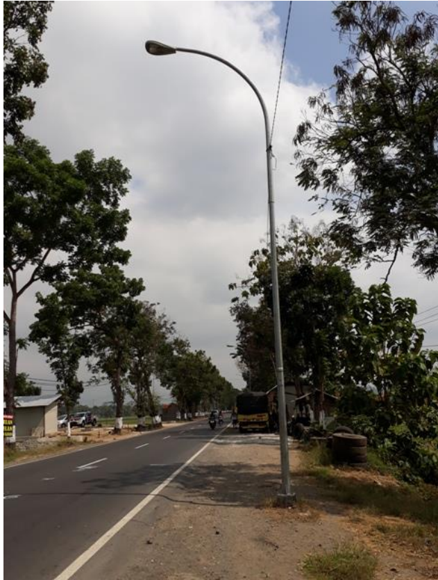
Gambar 14. Kondisi Lampu Penerangan Jalan Umum
