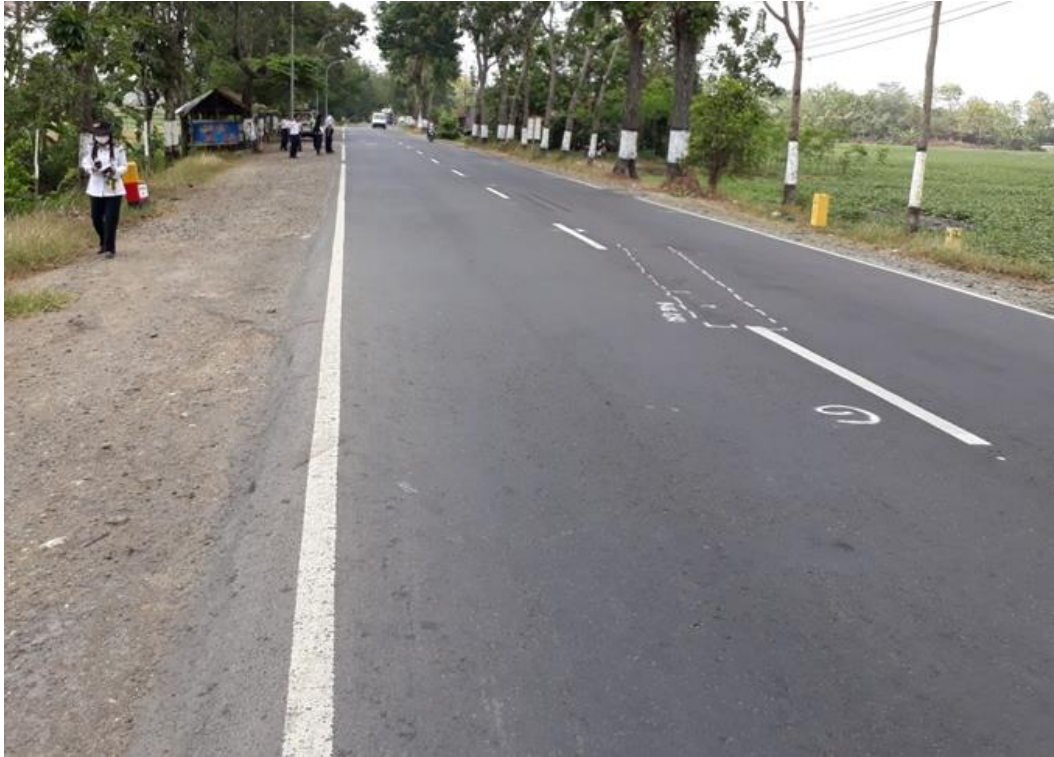
Gambar 13. Kondisi jalan pada lokasi terjadinya kecelakaan.
