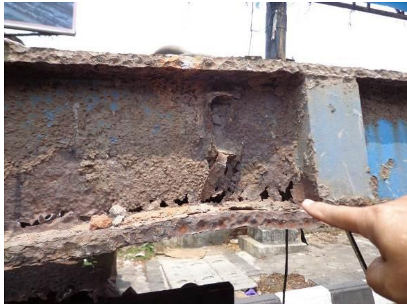
Gambar 33. Kondisi rangka landasan kereta tempelan.
