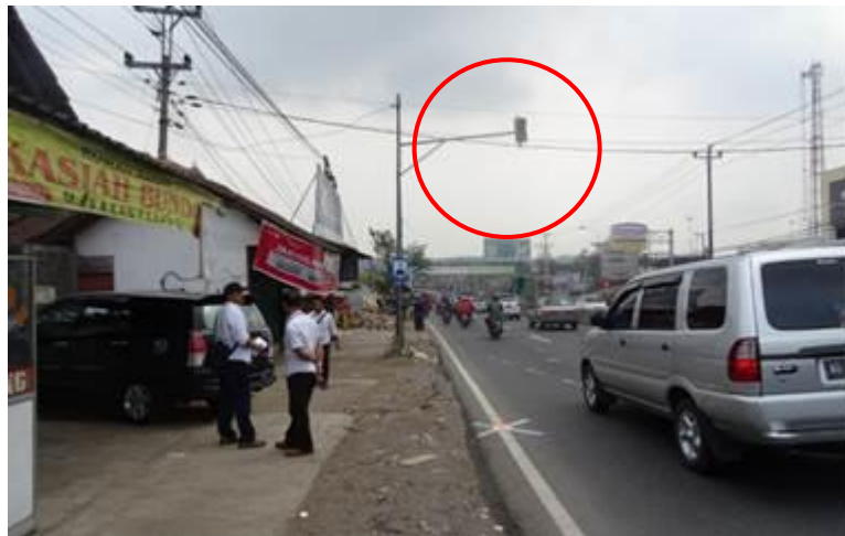
Gambar 46. Warning light tidak berfungsi.
