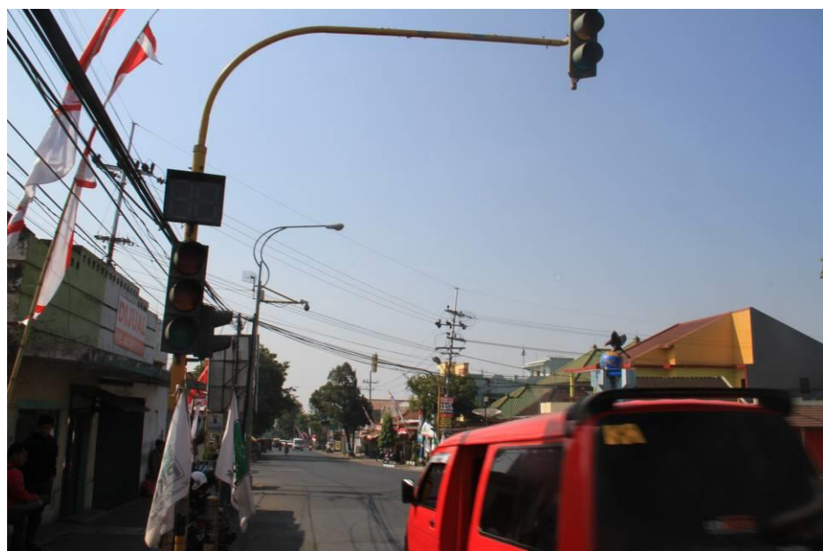
Gambar 21. APILL tidak berfungsi \pm 300 meter sebelum lokasi
