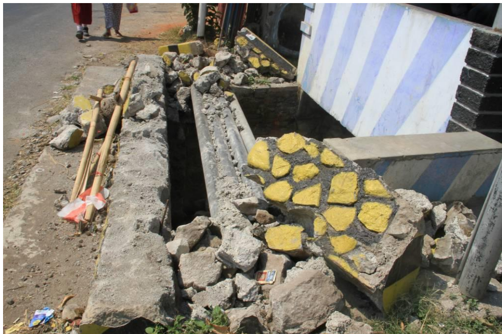
Gambar 7. Kerusakan Pagar Jembatan
