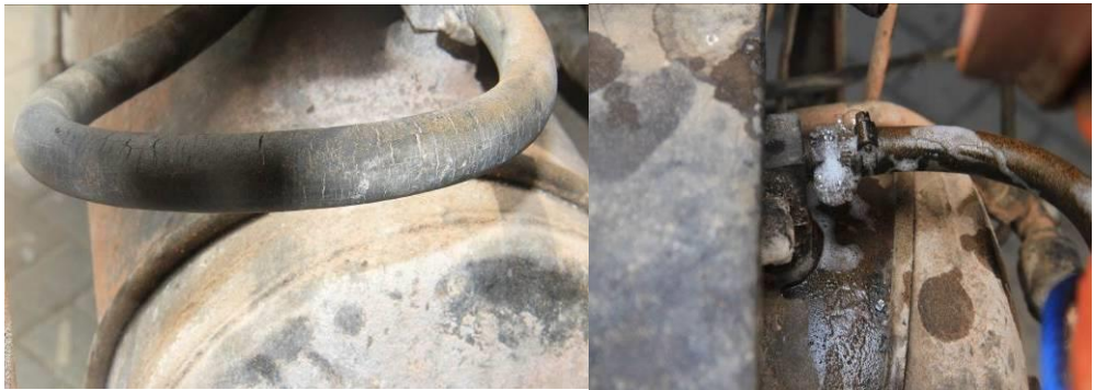
Gambar 9. Kondisi synthetic air hose mengalami penuaan dan bocor
