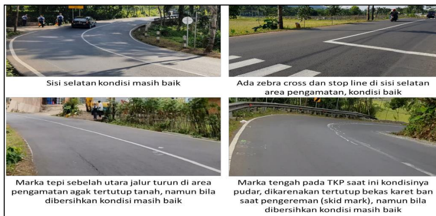
Gambar 11. Kondisi Marka Jalan di Area Pengamatan Lokasi Kejadian Kecelakaan
