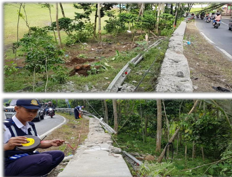
Gambar 17. Pagar Pengaman Jalan yang Jatuh / Rusak Akibat Kecelakaan Terdahulu
