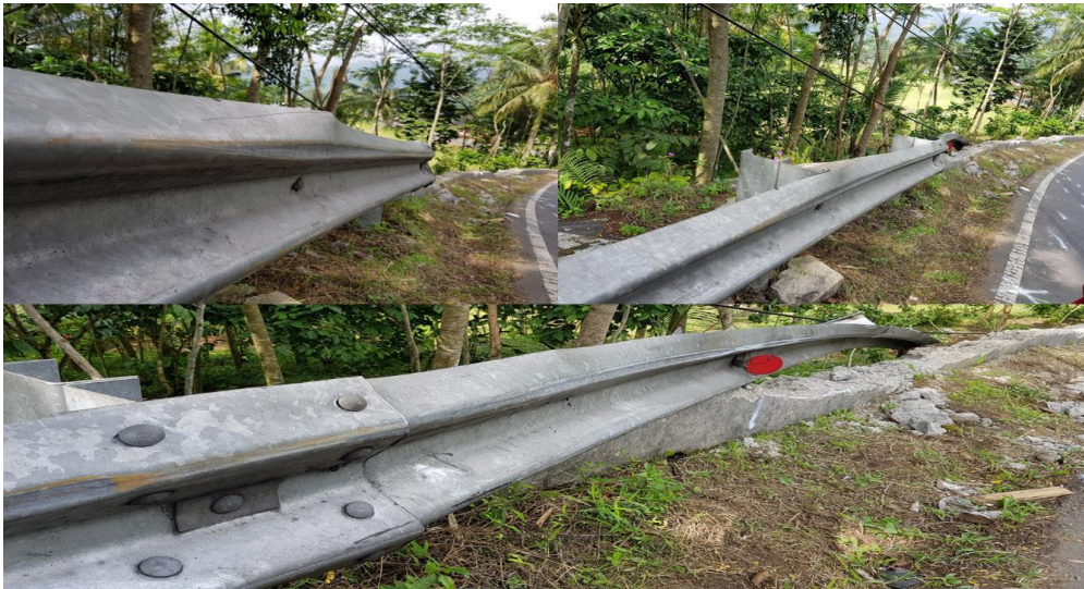
Gambar 18. Pagar Pengaman Jalan Yang Tertabrak Sebelum Bus Masuk Jurang
