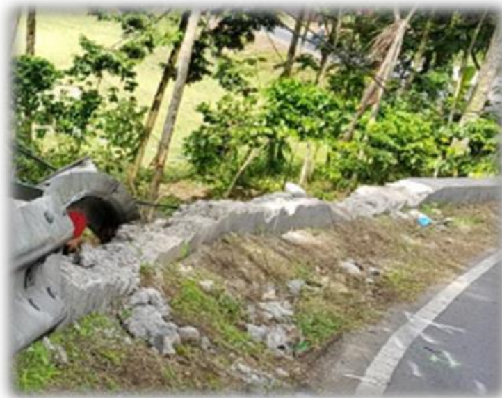
Gambar 19. Beton Penghalang yang Dilompati Sebelum Bus Masuk Jurang
