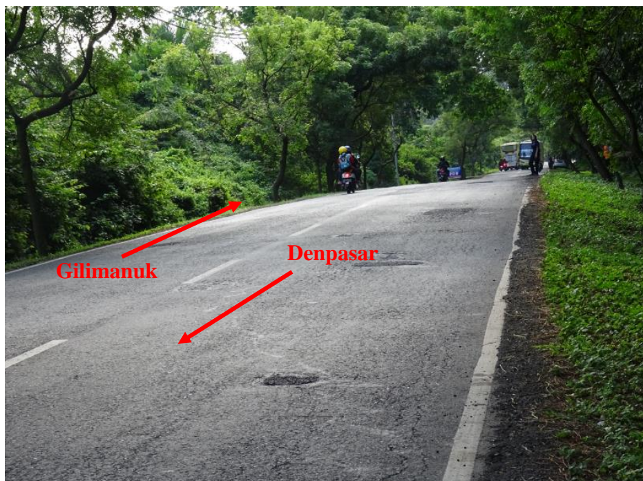
Gambar 18. Lokasi kecelakaan Km.121-122
