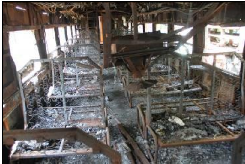
Gambar 5. Kondisi bagian dalam kereta pertama K3 0 66 40 yang terbakar
