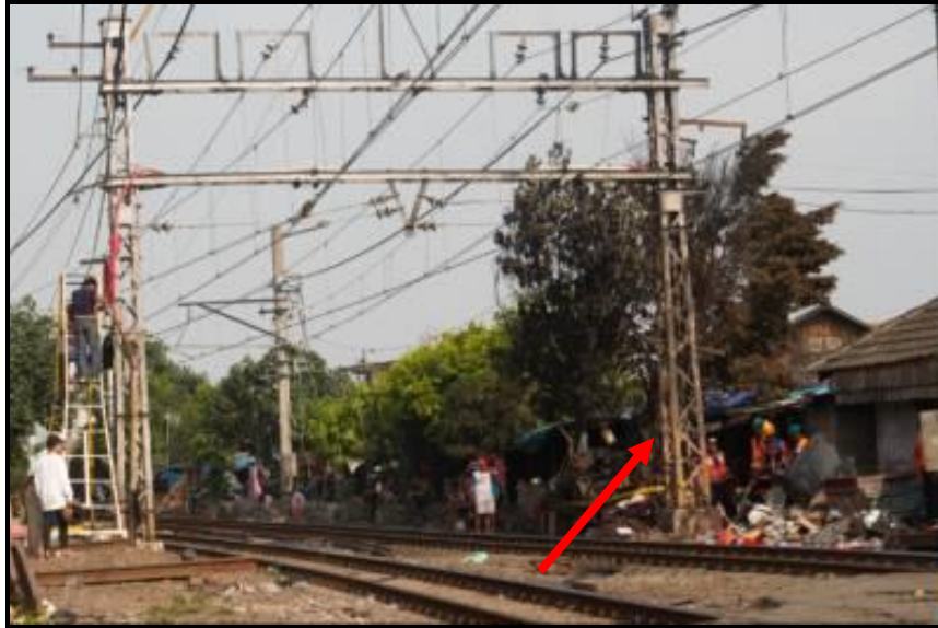
Gambar 7. Kondisi tiang listrik aliran atas yang terbakar
