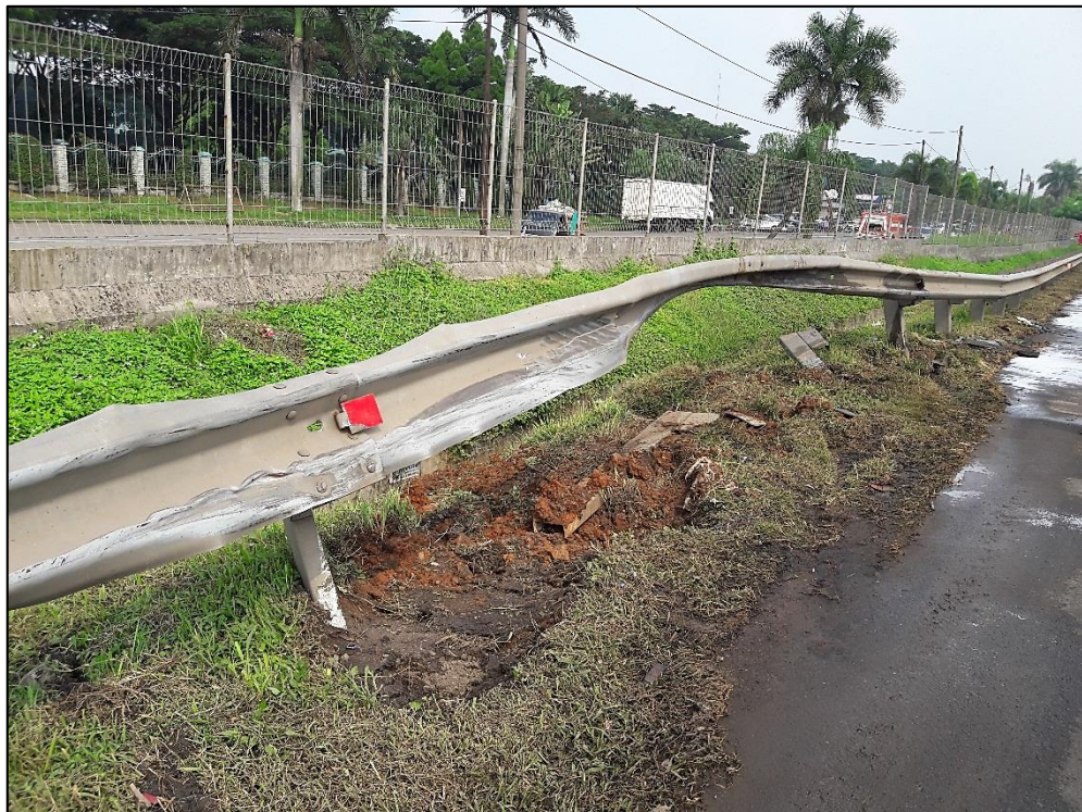
Gambar 13. Kondisi Guardrail Yang Tertumbuk
