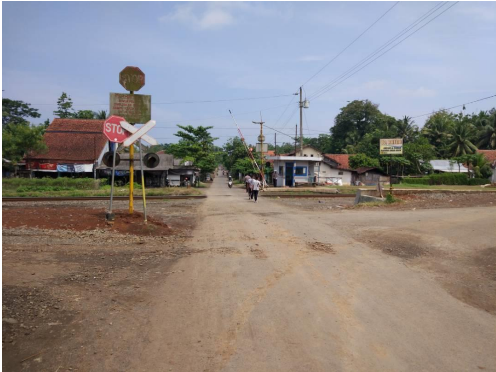
Gambar 8. Perlintasan dari arah Cilacap – Buntu yang tidak dilengkapi pintu
