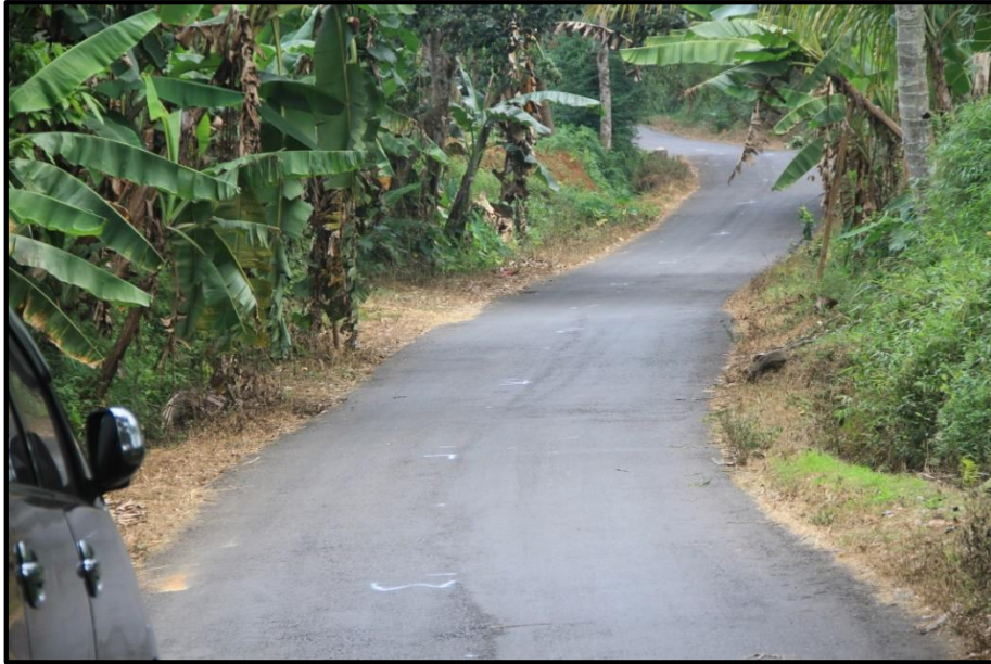
Gambar 9. Kondisi ruas jalan Tersono – Bawang tidak ada marka tengah dan batas tepi.
