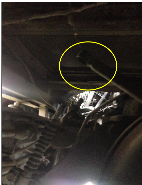
Gambar 9. Kabel rem tangan tidak terhubung
