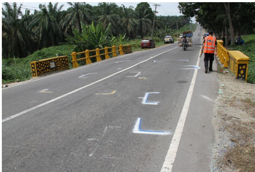
Gambar 12. Kondisi jembatan setelah kejadian kecelakaan
