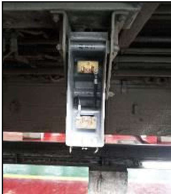
Gambar 11. Tutup fuse box (kotak sekring) dan fuse (sekring) hilang.
