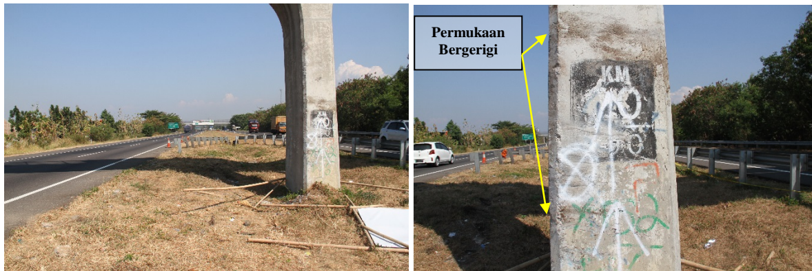
Gambar 16. Kondisi tiang penyangga jembatan pasca terjadinya kecelakaan.
