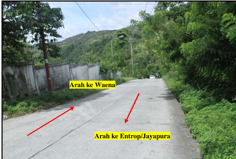
Gambar 25. Kondisi ruas jalan alternatif Perumnas III Waena – Entrop tanpa marka tengah dan batas tepi jalan.
