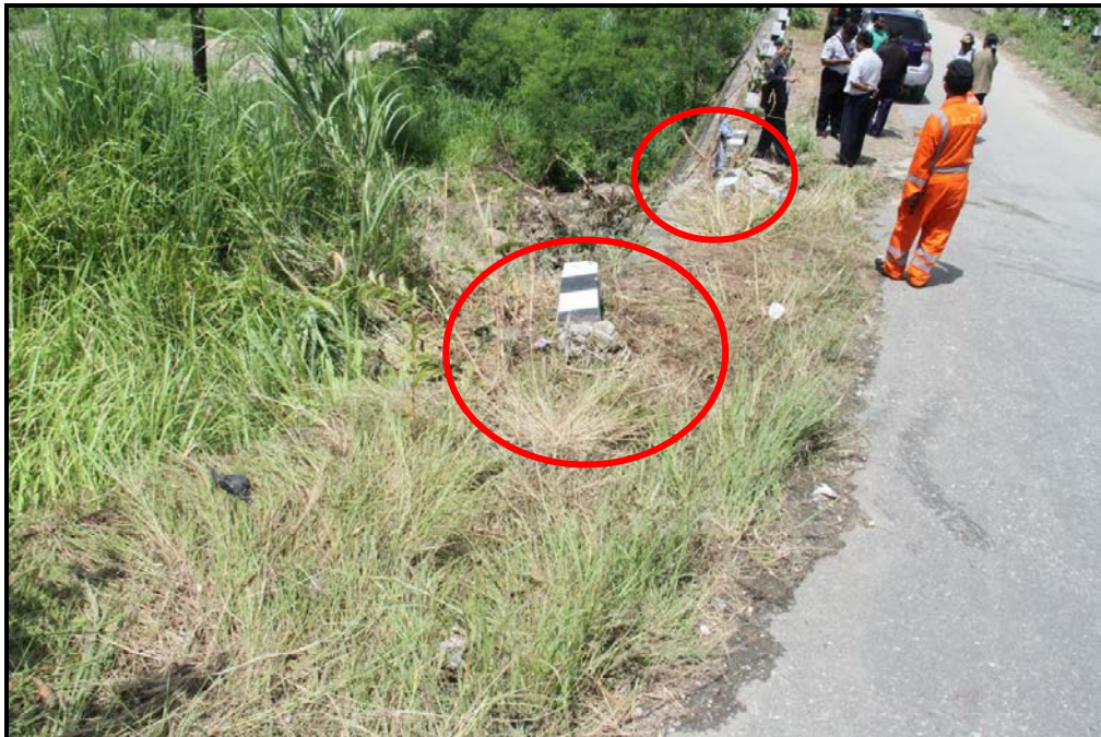
Gambar 11. Kondisi tiang-tiang pembatas (delineator) jalan yang patah dan roboh akibat tertabrak oleh mobil barang dump truck DS-9675-AB.
