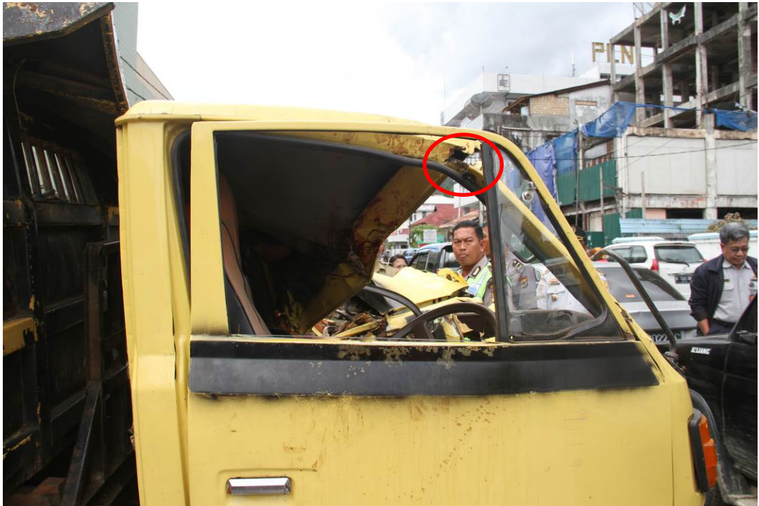
Gambar 21. Korosi pada superstructure kabin.
