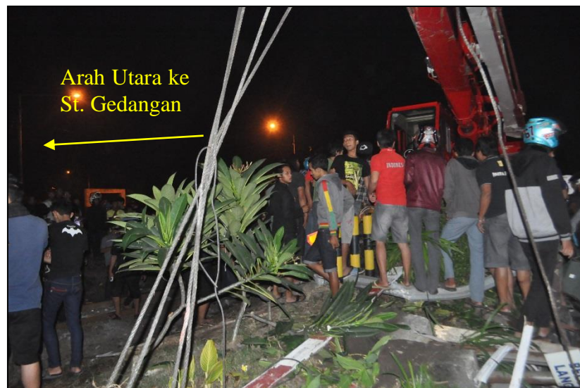
Gambar 18. Kabel crane yang terulur ka)rena tertarik KA KLB KP/10084.
