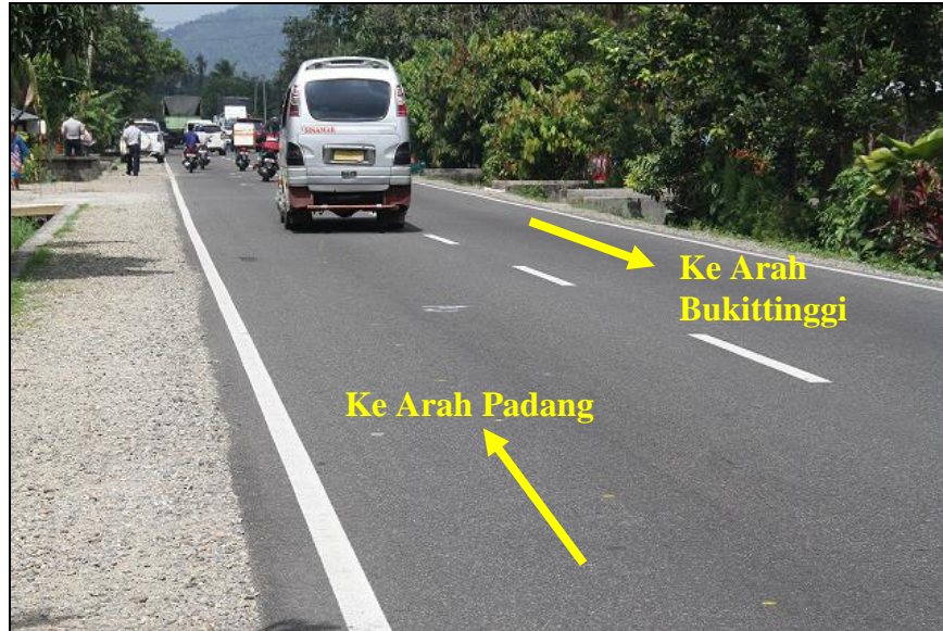
Gambar 7. Kondisi Jalan dilihat dari arah Bukittinggi ke Padang
