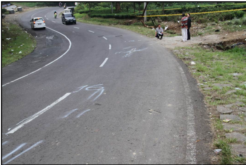
Gambar 24. Kondisi marka tengah dan marka tepi di lokasi
