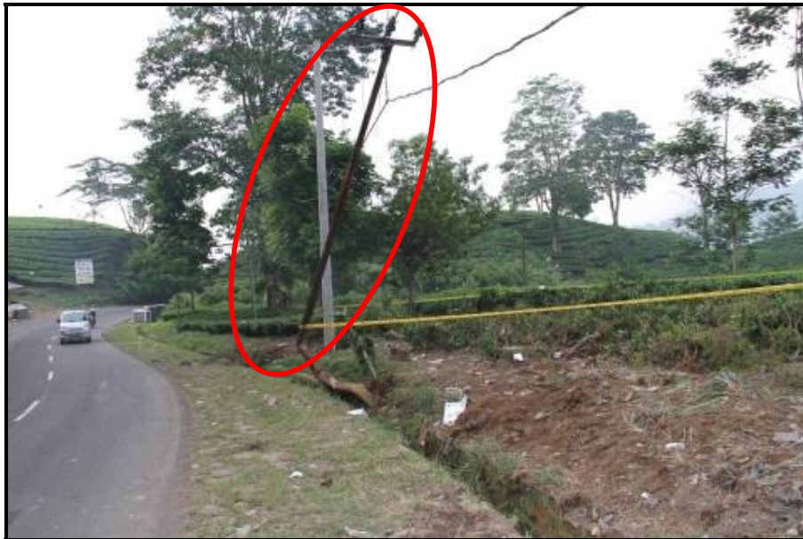
Gambar 14. Kondisi tiang kabel listrik yang bengkok akibat tertabrak oleh mobil bus.
