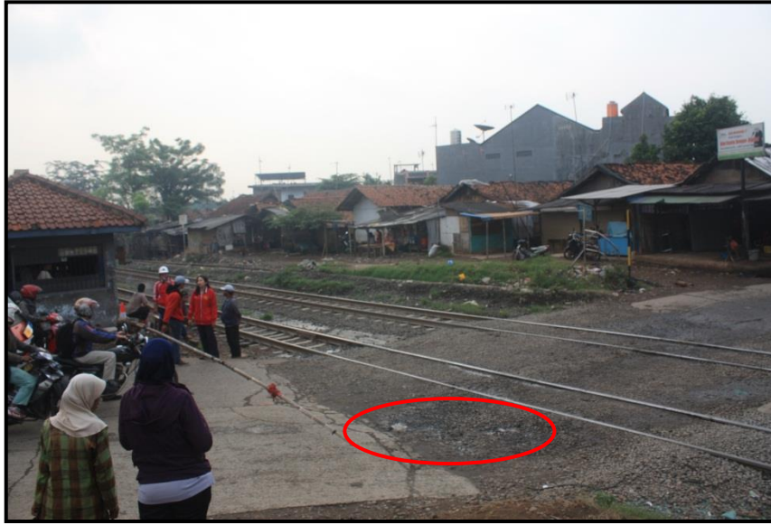
Gambar 11. Kerusakan jalan sebelum perlintasan sebidang.
