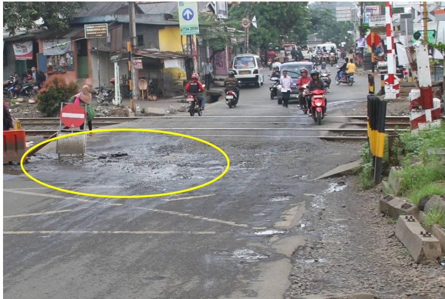
Gambar 13. Kerusakan jalan sebelum perlintasan sebidang
