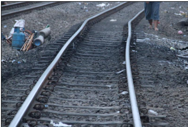
Gambar 11. Rel KA yang bengkok akibat kecelakaan
