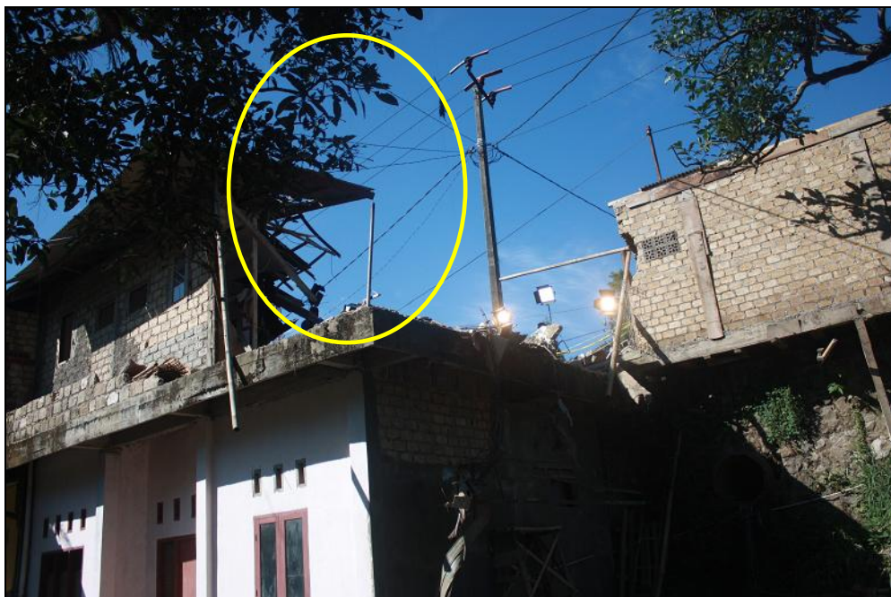
Gambar 9. Kondisi toko material dari arah sungai (utara), dinding bangunan toko hancur.
