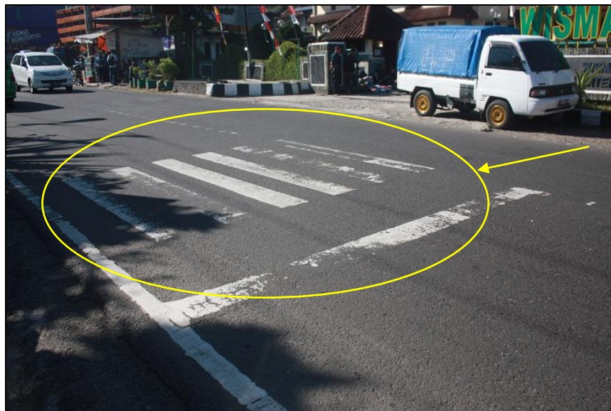
Gambar 13. Tempat penyeberangan orang ( zebra cross ), warna catnya sudah buram/terkelupas.
