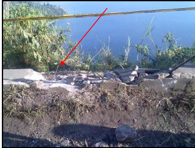
Gambar 7. Tanggul beton pengaman jalan yang tertabrak mobil bus BK-1170-XO
