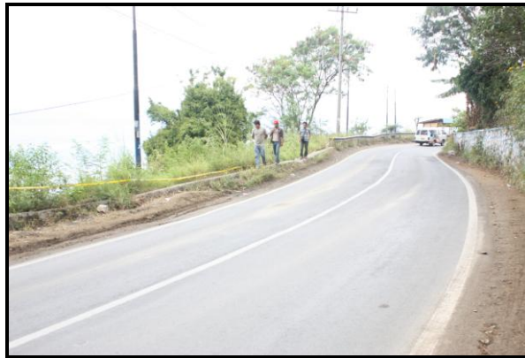
Gambar 10. kondisi ruas jalan Siantar – Parapat
