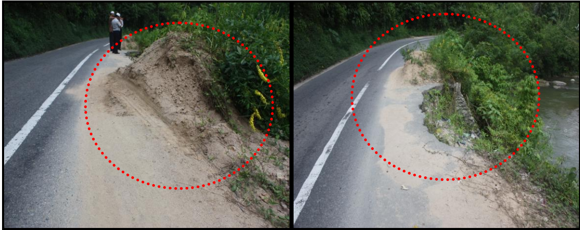
Gambar 15. Gundukan tanah yang terdapat di lokasi terjadinya kecelakaan
