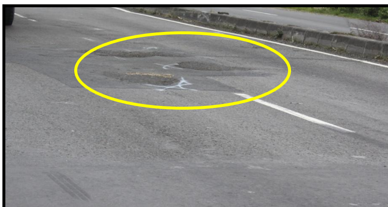
Gambar 7. Jalan berlubang yang telah diperbaiki sehari setelah kecelakaan
