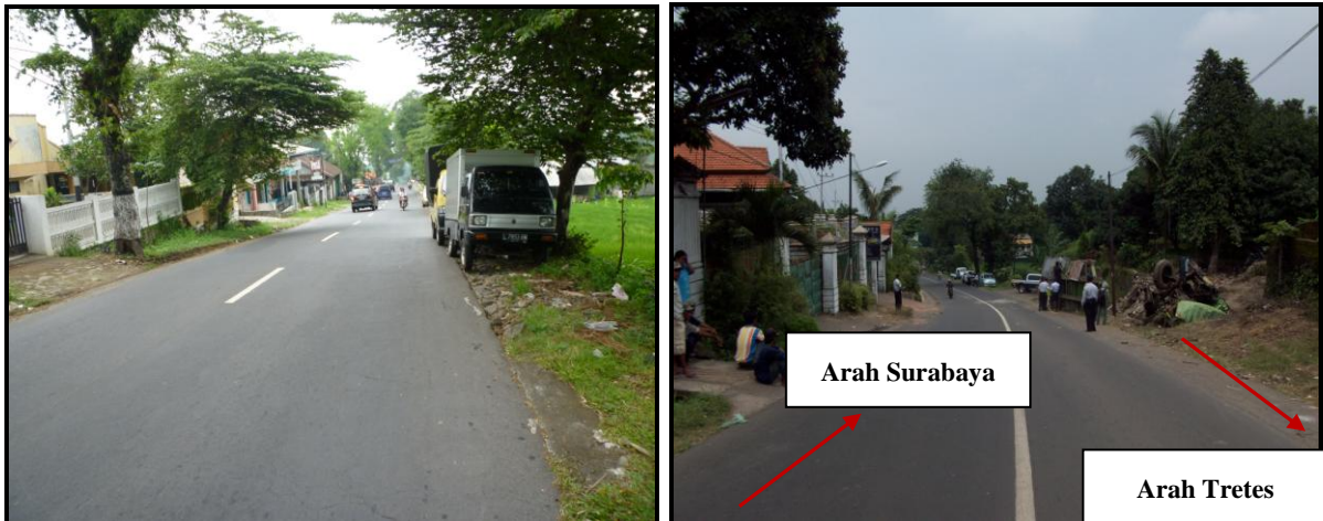
Gambar 19. Kondisi ruas jalan Pandaan – Prigen Desa Gambiran Kec. Prigen Kab. Pasuruan
