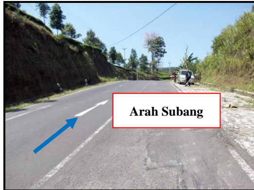
Gambar 12. Kondisi jalan arah Subang
