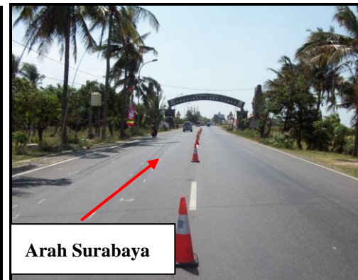
Gambar 17. Kondisi jalan arah Surabaya
