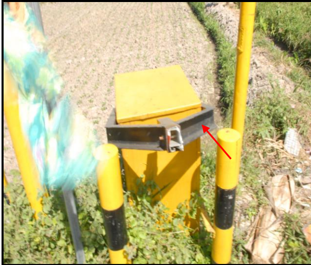
Gambar 4. Palang pintu perlintasan elektrik yang Patah/hilang
