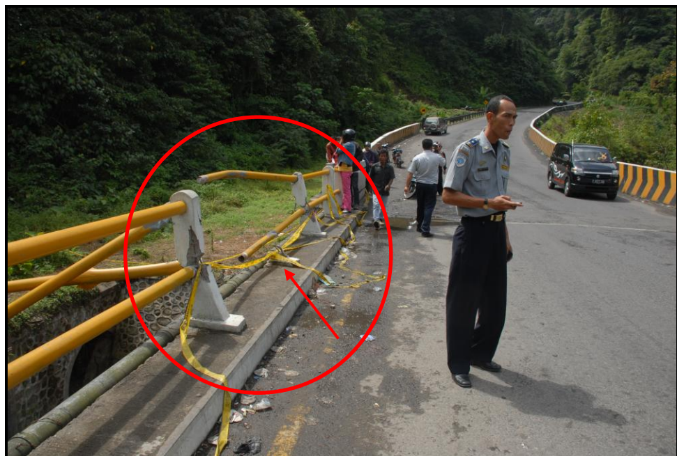
Gambar 13. Pagar jembatan yang rusak akibat tertabrak mobil bus BA 3824 E
