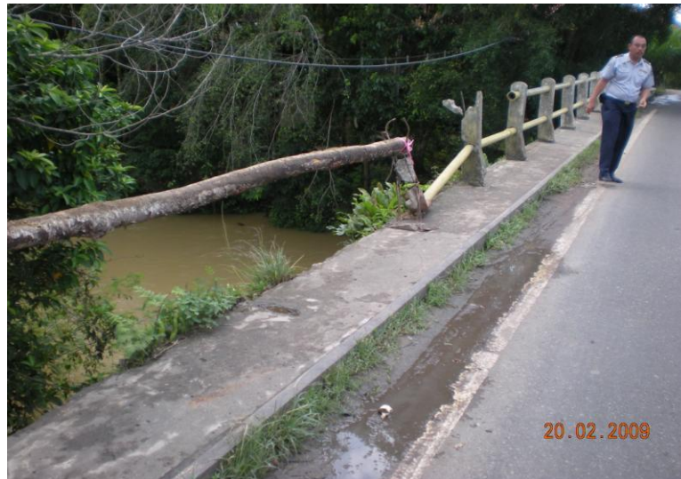
Gambar 5. Pagar pengaman jembatan yang hilang
