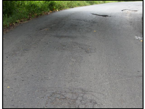
Gambar 7. Kondisi jalan ± 500 m sebelum lokasi kejadian
