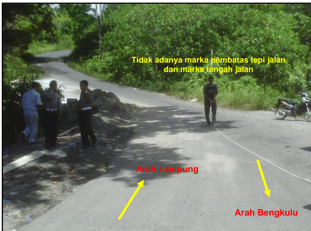
Gambar 15. Kondisi jalan yang tidak terdapat marka pembatas tepi jalan dan marka tengah jalan
