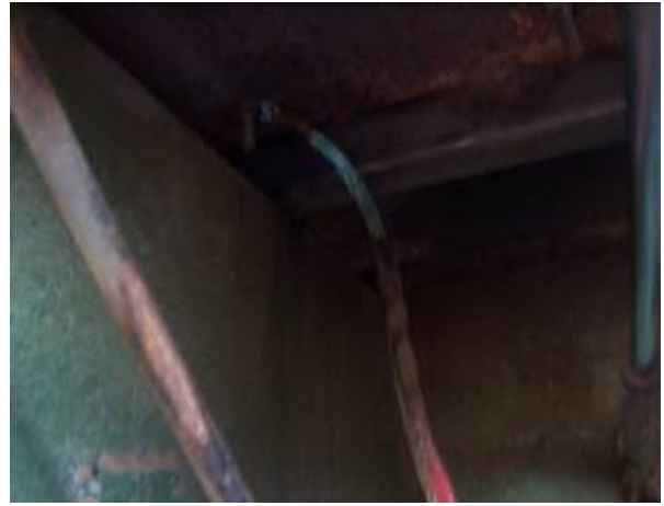
Gambar 20 kondisi kabel aki yang sudah aus/terkelupas
