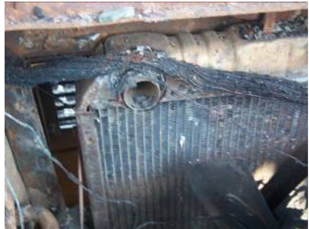
Gambar 22 kondisi radiator dan kabel di ruang mesin
