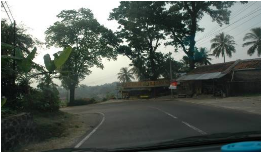
Gambar Prasarana 1 : Ruas jalan Subang - Ciater adalah jalur utama dari Jakarta menuju Kawasan Wisata Ciater
