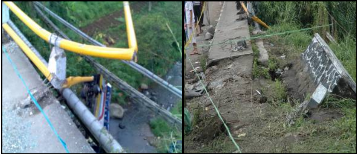
Gambar 2.15 Jembatan Cikundul mempunyai lebar jalan 7 meter, dilengkapi dengan pagar tembok pengaman dari batu kali. Dan pagar dari besi pipa yang dicat kuning. Setelah kejadian, tembok pengaman jembatan yang di sebelah kanan (dari arah Puncak Pass) terlihat rubuh terbongkar dan sebagian pagar besi jembatan juga rusak.
