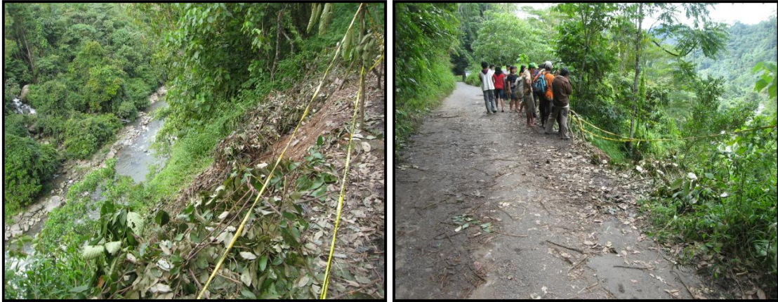
Gambar 5. Kondisi prasarana dan lingkungan di sekitar lokasi kejadian
