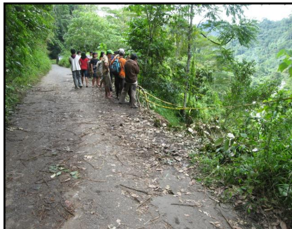
Gambar 3. Kondisi Prasarana di sekitar lokasi kejadian
